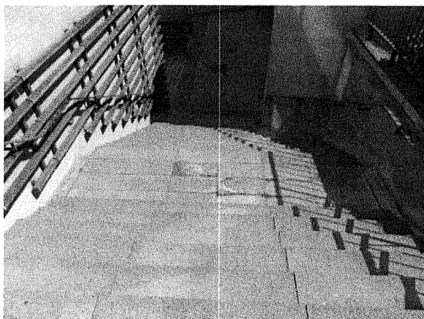
Trappe med enkelte skadede fliser.
